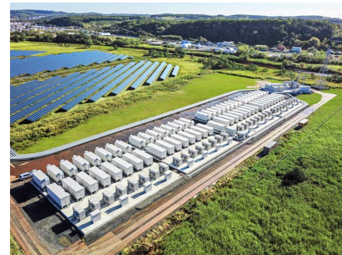
すずらん釧路町太陽光発電所の蓄電池
